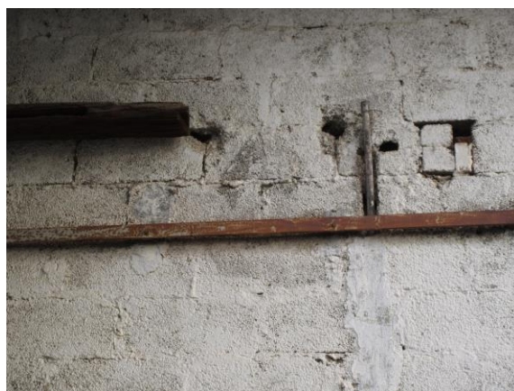
Foto 16: Kirchstraße 10 (Mauerlöcher Westseite)
